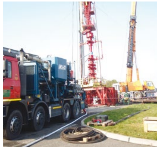
Souprava HWO Halliburton (uprostřed), cementační vysokotlaký agregát (v popředí), těžký jeřáb s nosností 120 tun (v pozadí).
