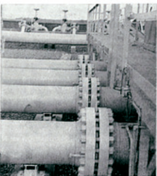
Studijním objektem se stala měřicí stanice v anglickém Bactonu, která se svým řešením podobá mezinárodním předávacím stanicím tranzitního plynovodu.
